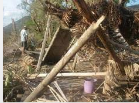
L'école communautaire d'Ambodiforaha, complètement détruite
