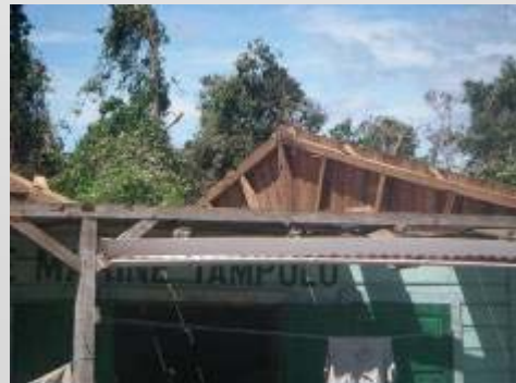
La sous-base de la parcelle marine endommagée
